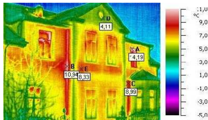
Abb. 1 zeigt eine ungedämmte Gebäudeaußenhülle mit undichten Wandanschlüssen und Wärmebrücken.
